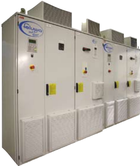
▲ Abb.: Schaltschränke mit integrierten Frequenzumformern und Touch Panels
